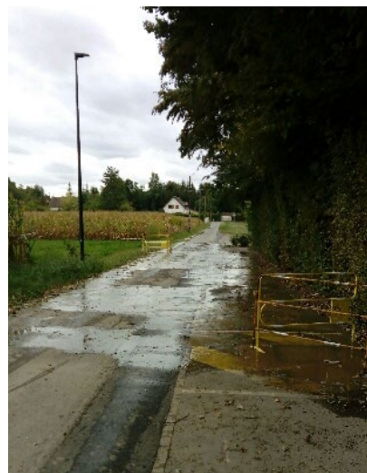
Une grosse fuite d'eau, chemin du prête
